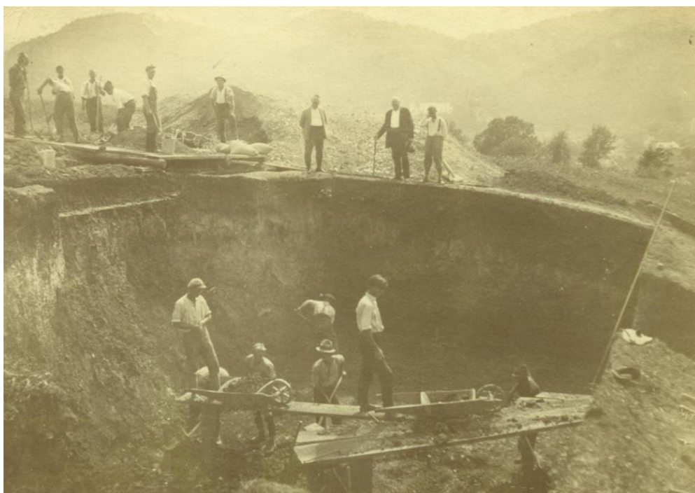
Fotografije: Izgradnja vodovoda v Šoštanju in izkop za rezervoar na Goricah leta 1930. 115
