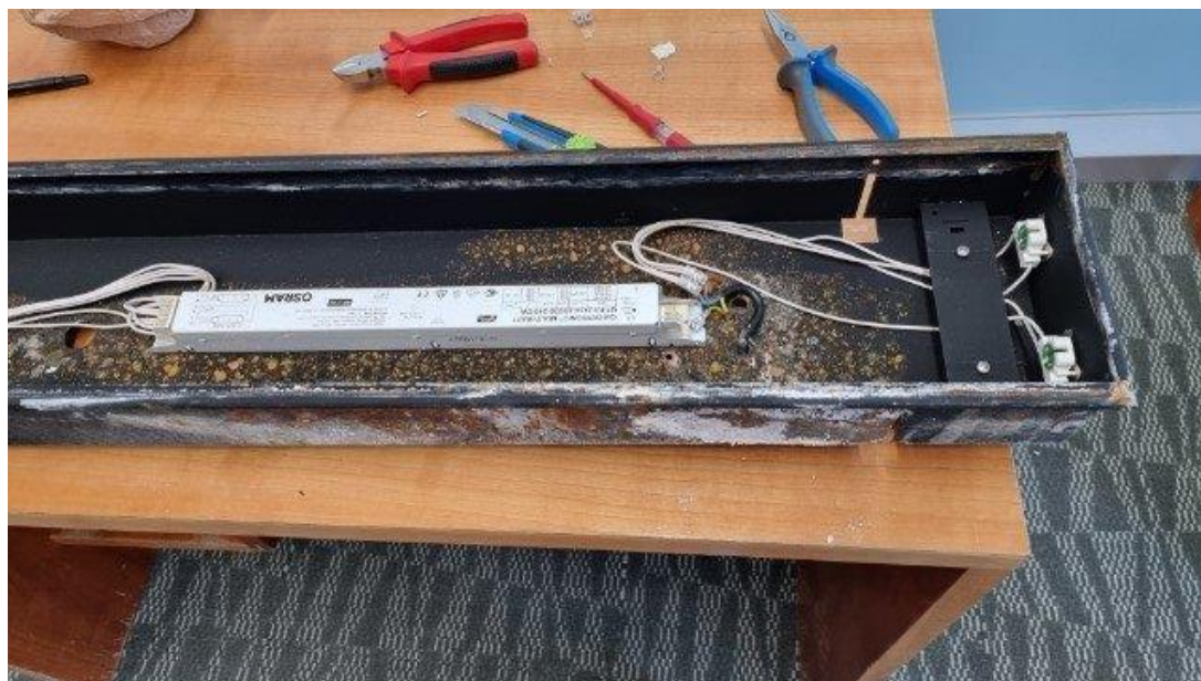
Slika 40: Stanje elektrike na stropu
