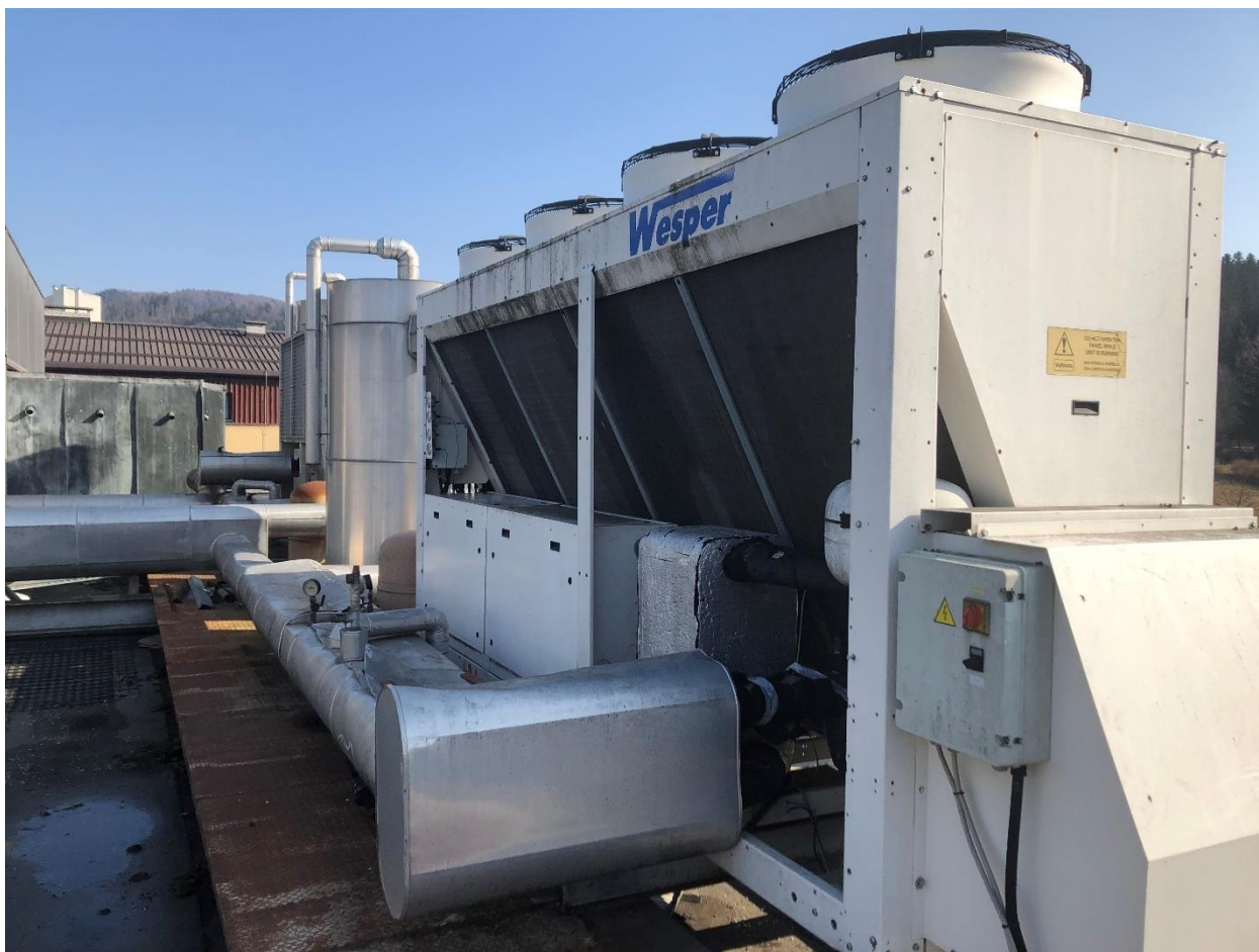
Slika 39: Hladilni agregat na strehi
