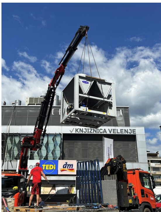
Novi hladilni agregat za Knjižnico
